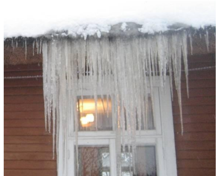
Joonis 3.44. Jääpurikad roogkatuse räästas (foto: S. Sõber)
