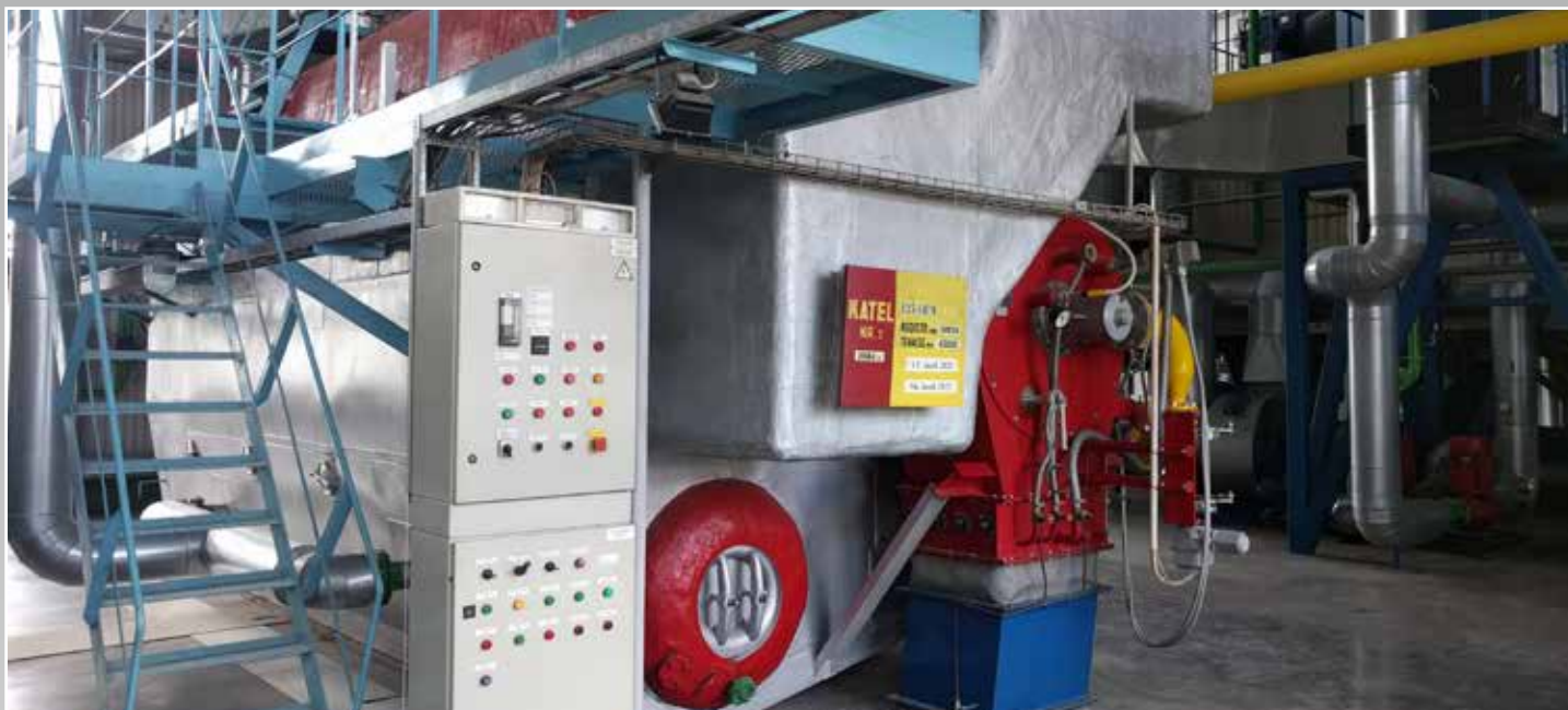
Foto 1: AS ESRO renoveeritud Männimäe katlamaja sisevaade.
