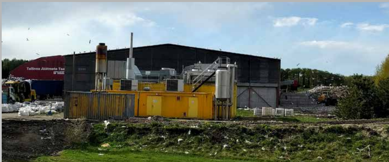
Prügilagaasil töötav koostootmisjaam Jõelähtmel asuvas prügilas.
