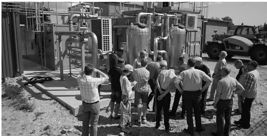
Foto 2: EBÜ liikmetele tutvustatakse Koksveres biometaani puhastusseadmeid ja -tehnoloogiaid.
