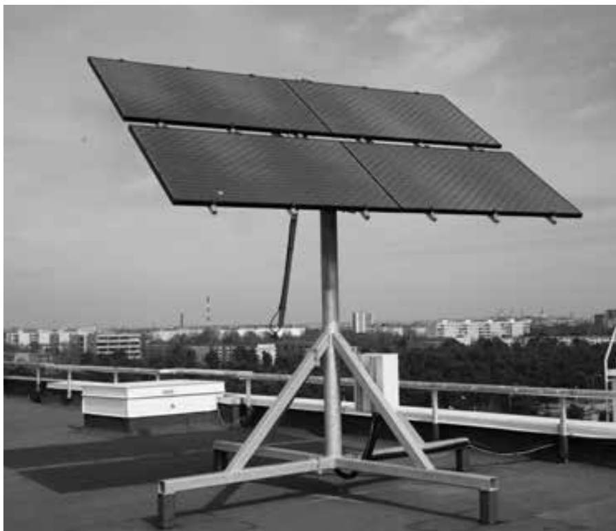
PV-paneel Tallinna Tehnikaülikooli energeetikamaja katusel.
