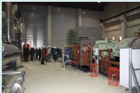
Generaatorisaal. Generators room
