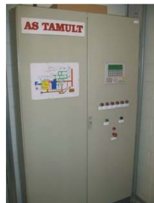
Katlamaja kontrolliritega automaatsuhtumise kilp
