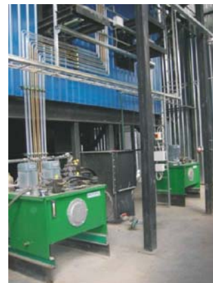
10-MW mehaanilise restkolde ja tuhaärastuse hüdraulika agregaadid
