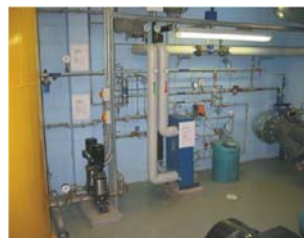
Katlamaja deaeraatorsüsteem ja lisavee süsteem
