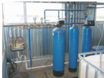
Katlavee automaatne rauaärastuse ja pehmenemise süsteemi filtrid
